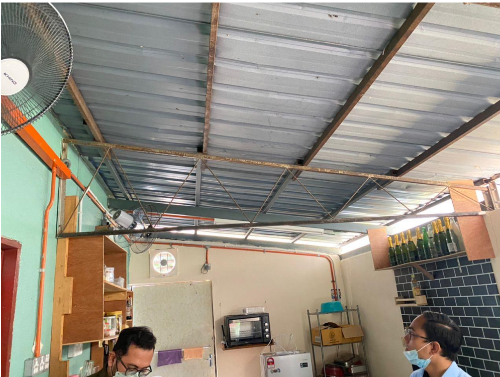
Keadaan bumbung ruang belakang dewan.
